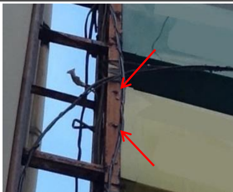
取付部(ボルトのゆるみや欠落)
