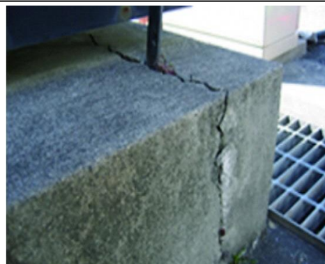
基礎部(基礎のクラック)
