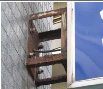
接合部(ブラケットの腐食劣化)
